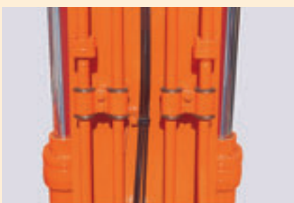
Более крупные резиновые крепления трубопроводов
